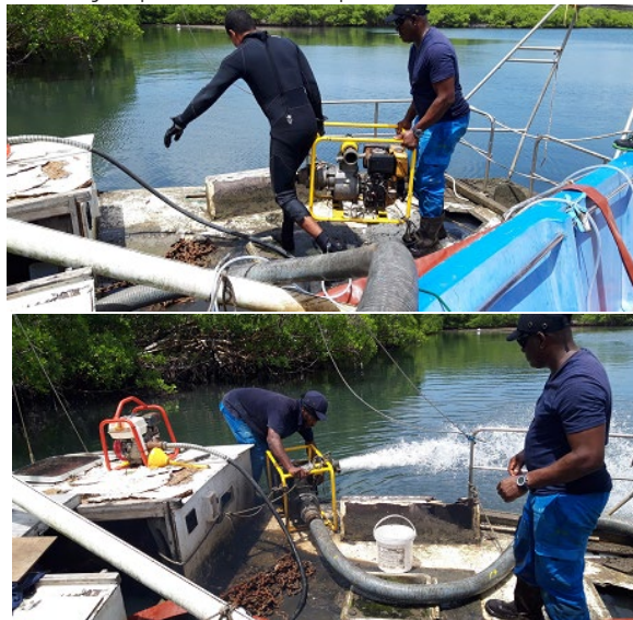
Figure 23 - Pompage - SOURCE : Caraïbes Environnement Développement
